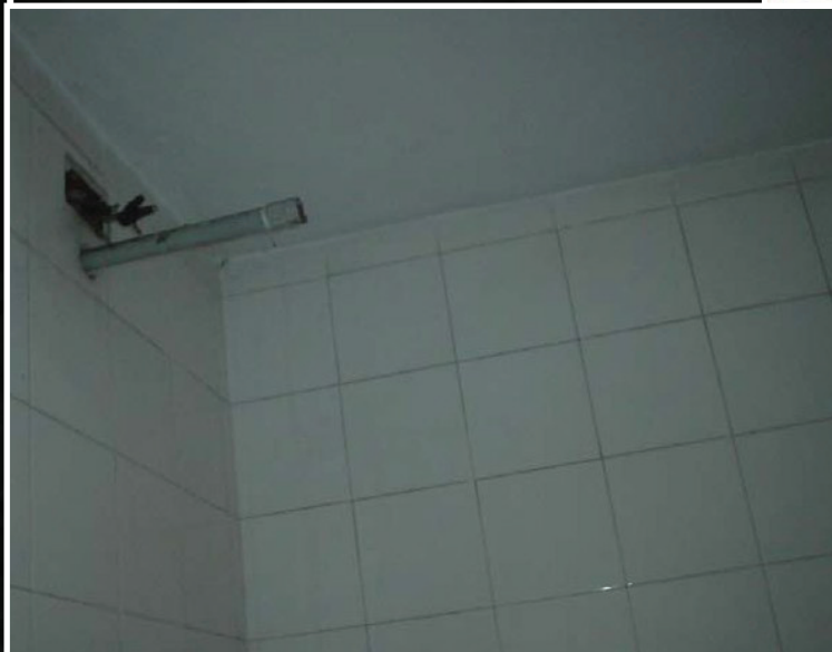
O chuveiro disponibilizado para os trabalhadores -encanamento para banhos frios.
